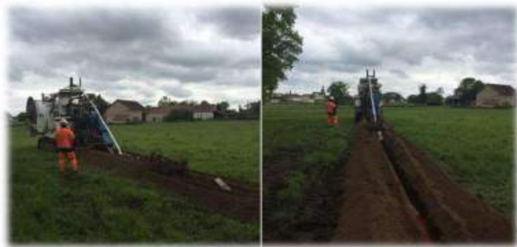
Figure 129 : Exemple de chantier d'enfouissement d'un réseau électrique en terres agricoles (source : Cegelec infra)
