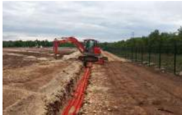
Figure 113 : Exemple d'enfouissement de câbles électriques HTA
